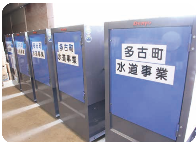
取水井用発電機
