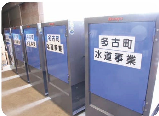
取水井用発電機
