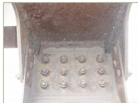
No.47 栗山川大橋【健全性Ⅱ】 (主桁) 防食機能の劣化
