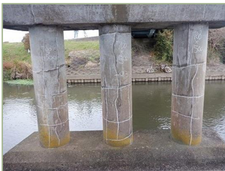
No.34 新竹橋【健全性Ⅱ】 (下部工) ひびわれ
