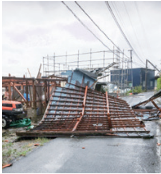
強風で屋根がめくれた農機具小屋
