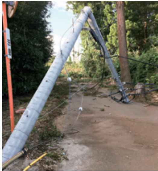
完全に折れた電柱
