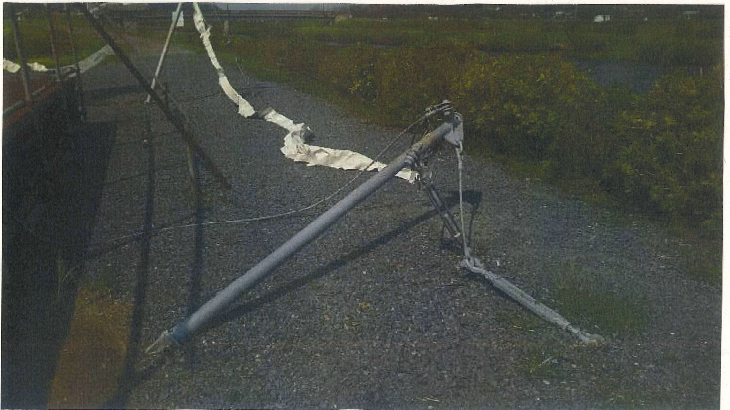
⑩破損後(倒れた支柱)
