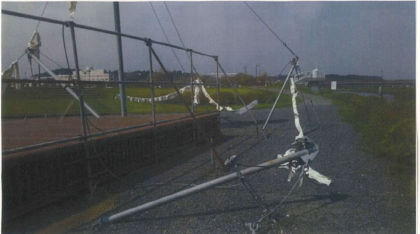
⑨破損後(倒れた支柱)
